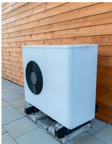
Wärmepumpen haben eine größere Auswirkung auf das Stromnetz als allgemein bekannt.
